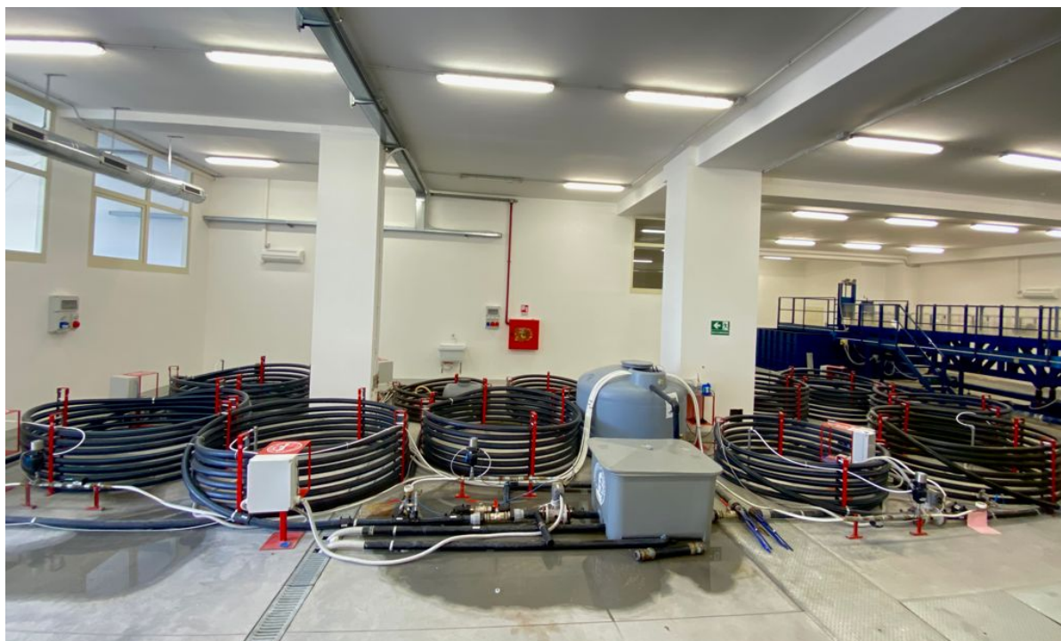
Figura 3 – Panoramica della rete idrica sita nel Laboratorio di Idraulica Ambientale.
